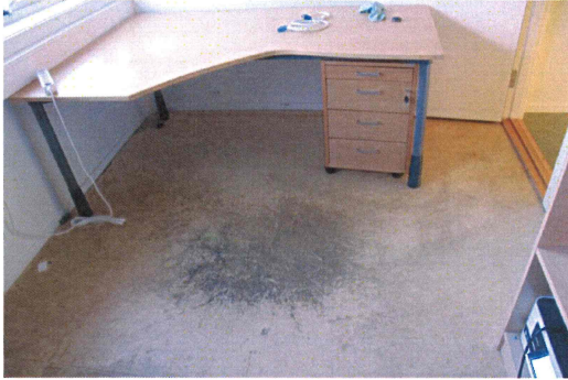
Slitasje på gulv, ccellekontor.
