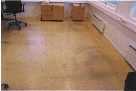
Slitasje på gulv
