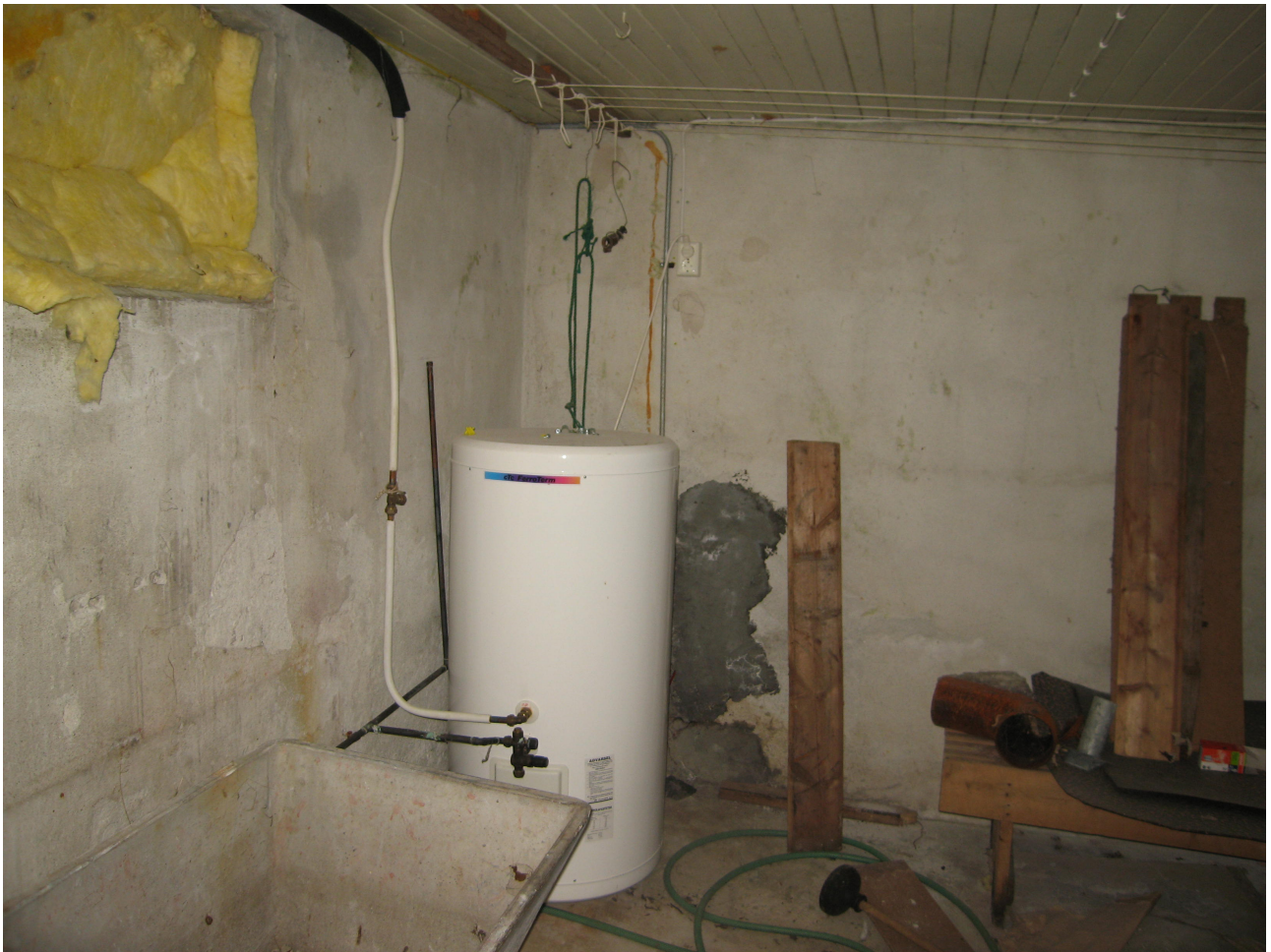
Kjellerrom med vv-bereder.
