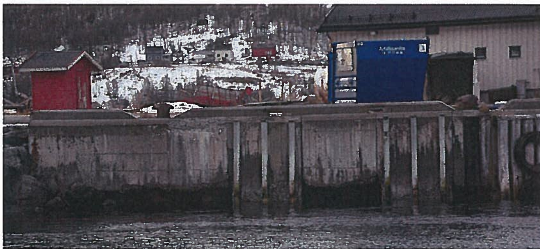
Figur 1.2 Østsiden av kaia i Burfjord med store betongskader.
