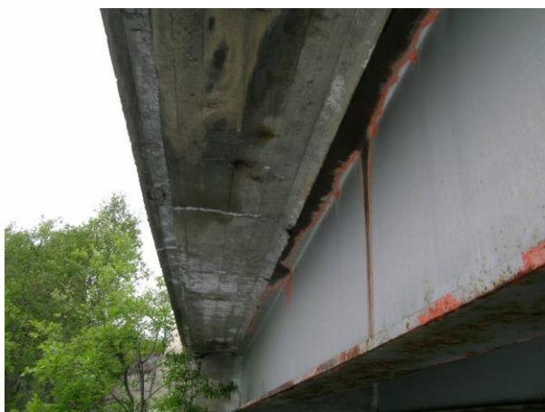
Figur 50 – Fukt på bjelke og betong.
