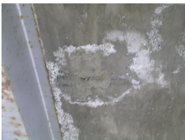
Figur 22 – Fuktgjennomgang og kalkutfelling.
