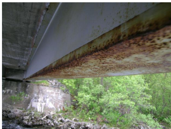
Figur 49 – Korrosjon av ytre bærebjelke.
