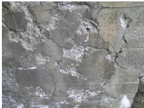
Figur 45 – Avskalling av betong.
