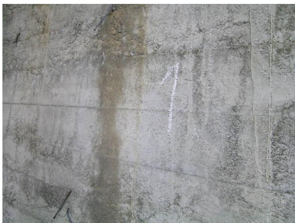
Figur 18 – Fukt og armering i akse 1.
