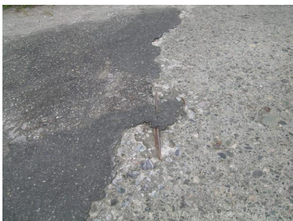
Figur 38 – Slitt og ujevnt veidekke.
