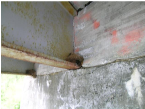
Figur 44 – Reir ved bjelkeopplegg.
