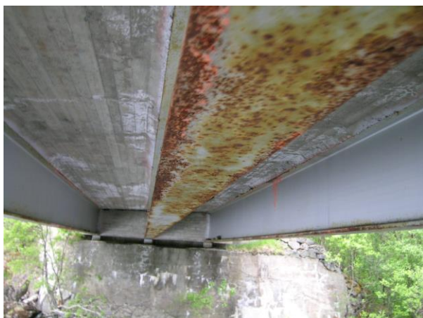
Figur 48 – Korrosjon av midtre bærebjelke.
