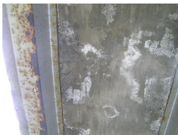
Figur 23 – Korrosjon av bjelke og kalkutfelling.
