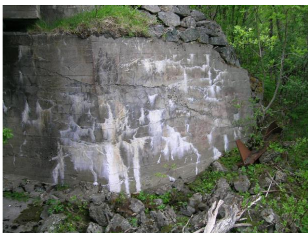
Figur 56 – Riss og kalkfelling i opplager.
