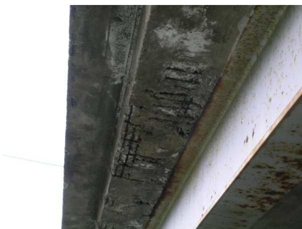
Figur 20 – Avskalling og frilagt armering.
