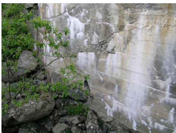
Figur 40 – Dårlig støpeskjøt landkar akse 2.
