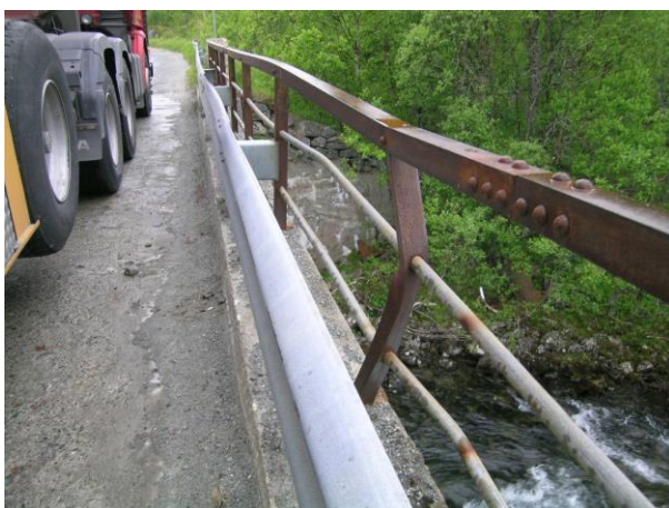
Figur 32 – Brøyteskade på rekkverk.
