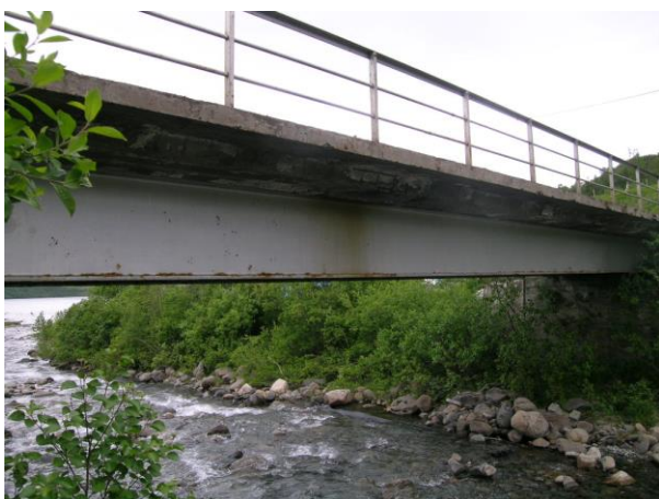
Figur 28 – Fuktskader og avskalling.
