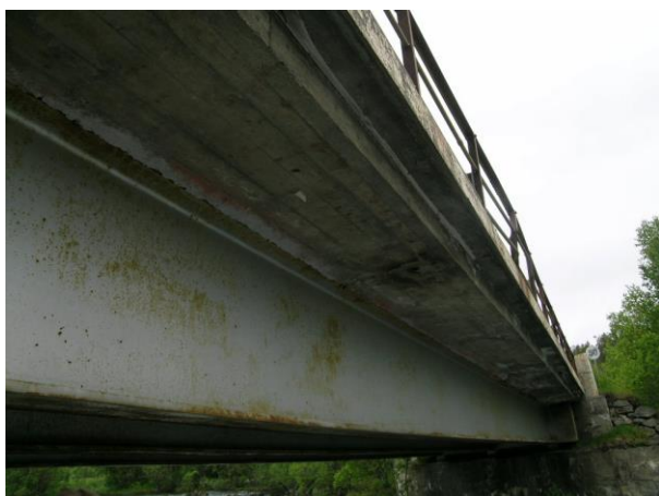
Figur 46 – Korrodert bjelke og tett nedløp.
