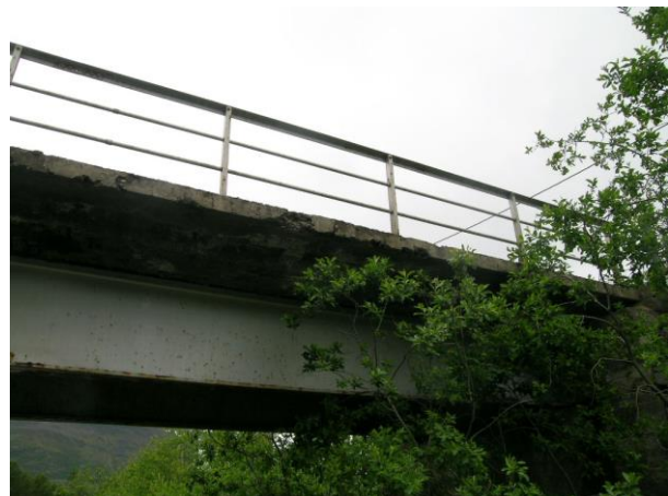
Figur 27 – Avskalling av kantbjelke.
