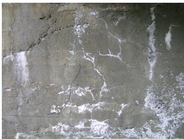
Figur 47 – Kalkfelling og utstikkende armering.
